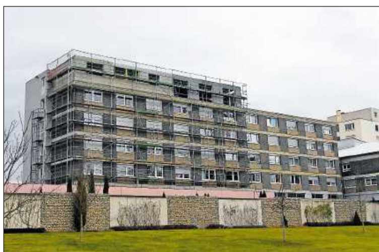
Von der Stadt stillgelegt: die Baustelle am früheren Hotel. FOTO: BOLTE
